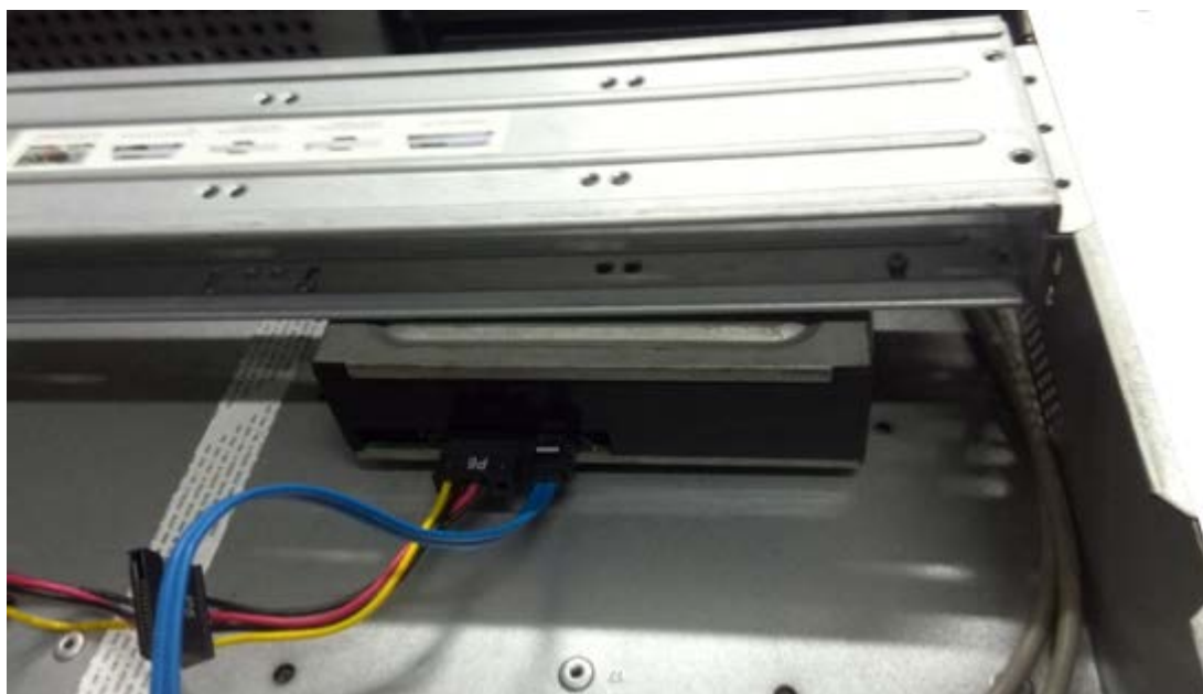
Figura 3-46 Cables de conexión
